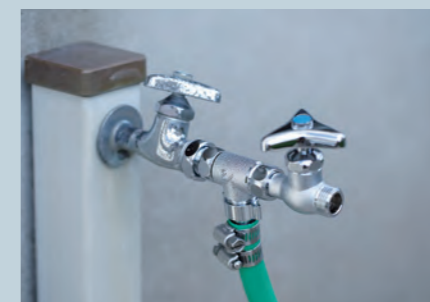
給水はトイレ用に分岐して使用します。
